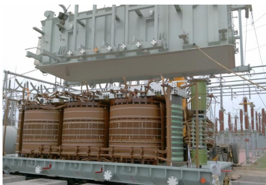
图 14：变压器实物图
