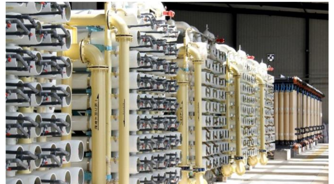
图 7：唐山南堡污水资源化项目（5 万吨/日）
