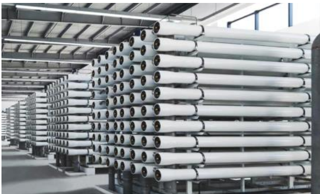
图 6：张家港四厂一期（国内首座 10 万吨/日纳滤自来水厂）
