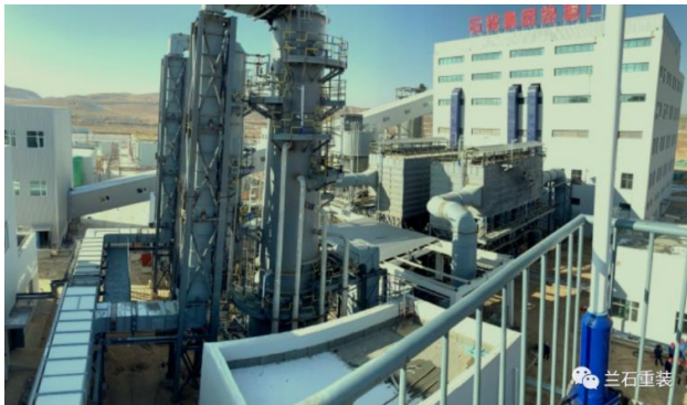
图 30：循环流化床锅炉烟气除尘脱硫脱硝项目
