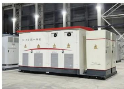
升压变流一体机
