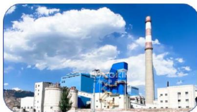
内蒙山晟能源1# CFB炉超低排放装置
