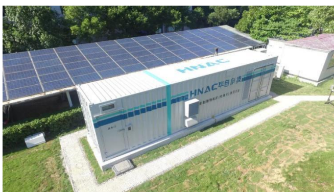
图24：华自科技园区内有自建微电网项目
