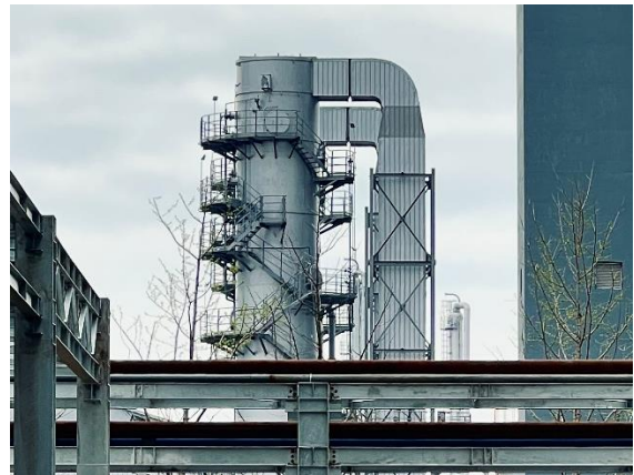
图27. 新工厂旁热电站实拍
