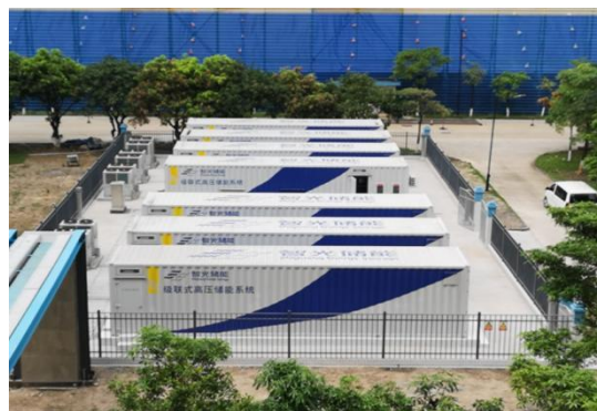
图 14：公司火储联调 9MW/5MWh 级联式高压储能系统
