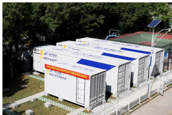
图 13：公司首台商业级 5MW/3MWh 级联式高压储能系统
