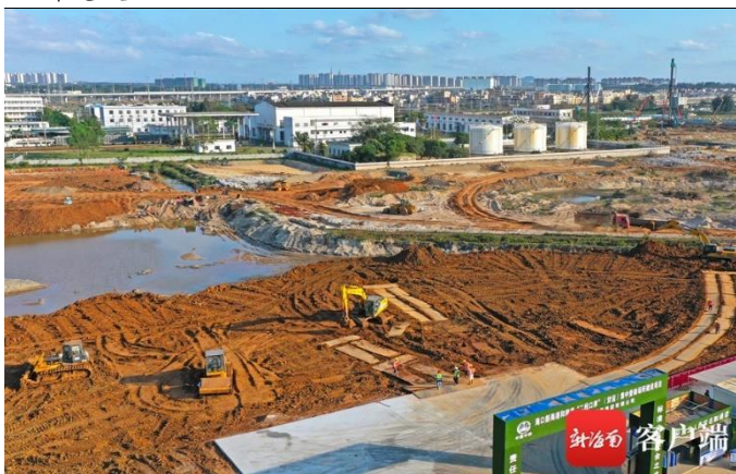
图21. 海口新海港和南港“二线口岸”（货运）集中查验场所建设现场
