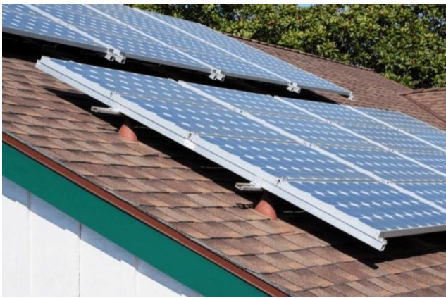
图 18：BAPV 建筑附着屋顶光伏
