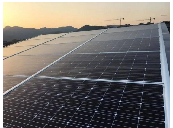
图 19：BIPV 建筑光伏一体化屋顶
