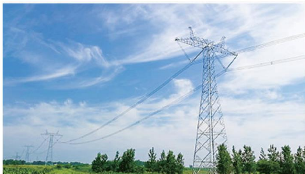
昌吉~古泉±1100kV特高压直流输电线路工程
