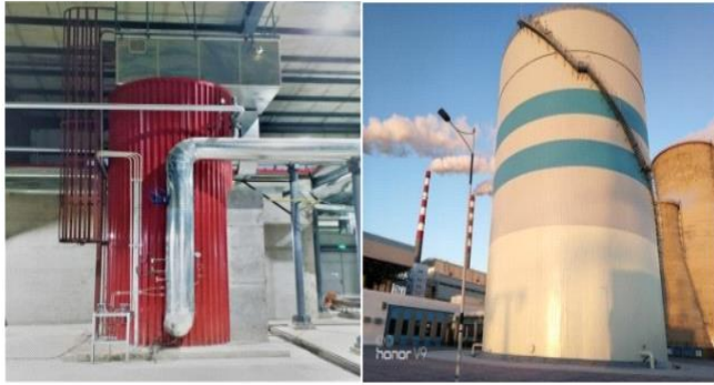
图 36：清洁能源消纳系统实景图
