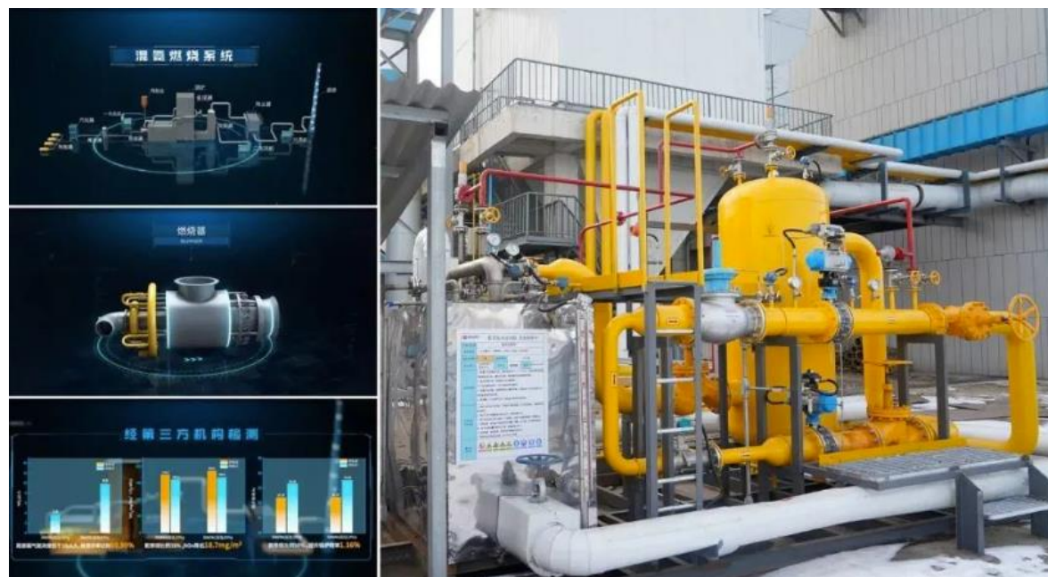
图表36：公司混氨燃烧装置
