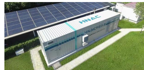
图2：多能物联技术应用——园区微电网示范站
