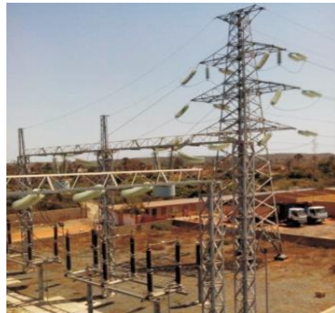
塞内加尔SOMETA公司90kV/10kV变电站项目
