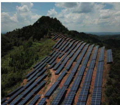
泸溪县93个贫困村光伏扶贫EPC总承包项目
