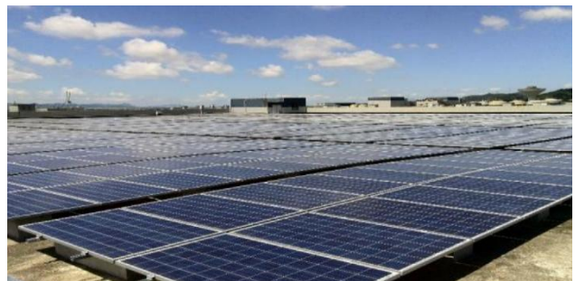
图表34：电站运营：珠海新青工业园太阳能光伏发电项目
