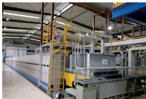
图 25：新天力负极材料烧结辊道窑（氮气气氛）
