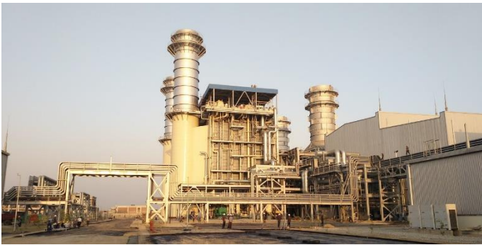
图 21: 巴基斯坦必凯 9H 燃机余热锅炉
