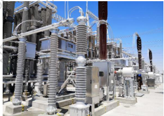
图表 49: 内蒙古扎鲁特旗的 ±800 千伏扎鲁特换流站工程
