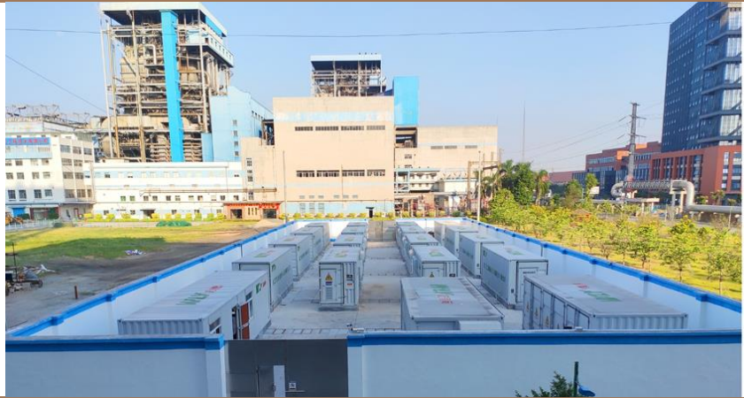
图 28: 2020 年发电公司发电侧电网储能调频项目取得成功
