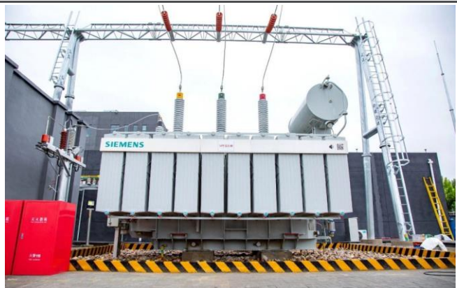
图29: 自建国际信息港 110 千伏用户变电站局部图
