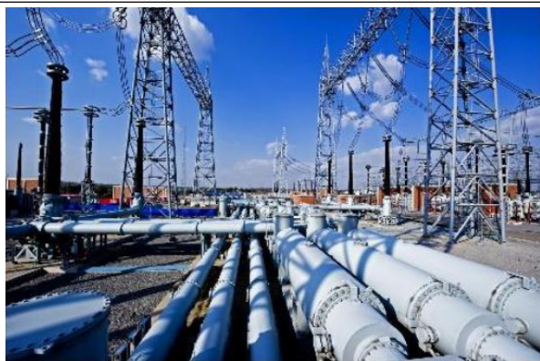
图5：国内首套 1100kV GIS 产品应用于首条特高压示范工程
