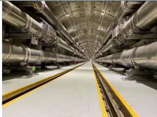
图6：国内首套 1100kV GIL 产品应用于苏通 GIL 管廊工程
