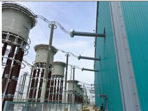
图 29：公司直流穿墙套管应用于白鹤滩-江苏直流工程
