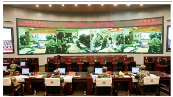
图 17：某基地导调控制大厅多功能综合信号处理平台
