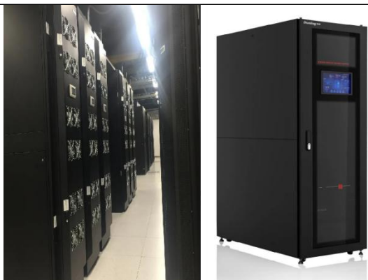
图 80：申菱数据中心液冷机组
