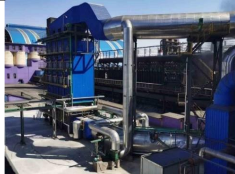
图 2：神华蒙西煤化股份有限公司焦化一厂焦炉烟气脱硝 EPC 总承包工程（公司环境治理服务项目）
