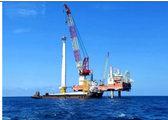
图57. 海上风机安装平台
