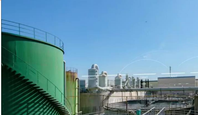
图 32：全生物污水处理设施
