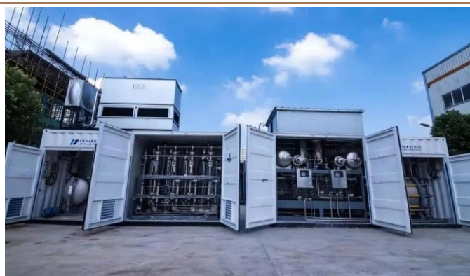
图 56：公司碱性电解水制氢及纯化装置
