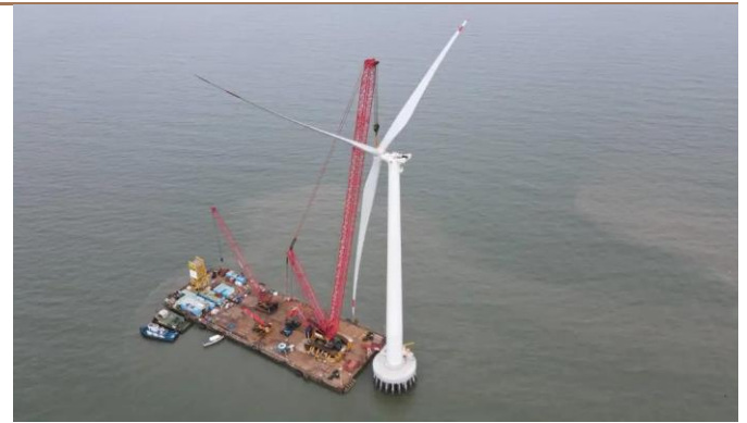
图 44: 越南金瓯 350MW 海上风电项目
