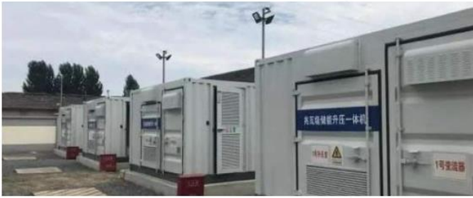
图33. 镇江扬中五峰山 24MW/48MWH 储能电站
