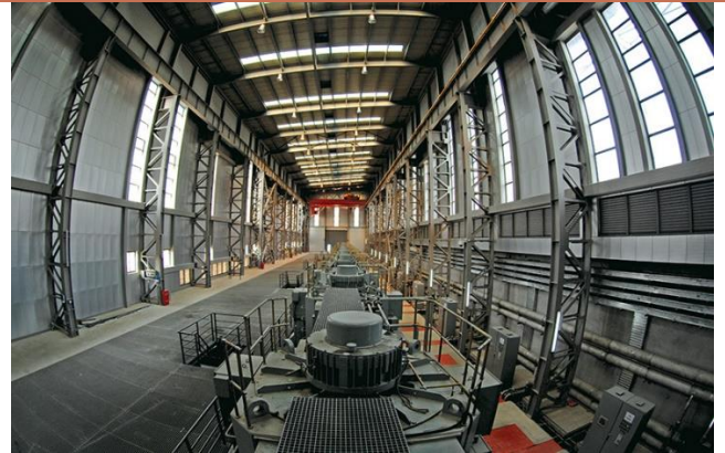
图 10: 上海青草沙水源地 5 号沟泵站工程机组
